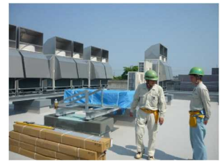
屋上室外機配線
