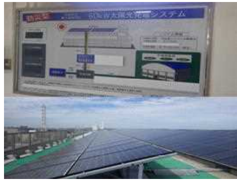
発電システムの説明とソーラーパネル
