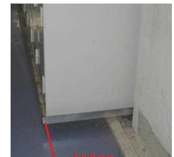
写2 ロッカーの出っ張り
