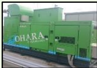
バイオガス発電機
