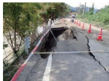
阿賀町 阿賀野川の増水により川側ブロック積基礎からの土砂の吸出しにより道路が欠壊
