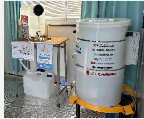
石川県珠洲市、輪島市に設置されたバイオランドリー
