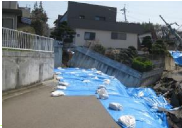
(c)腹付け盛土の崩壊の事例
