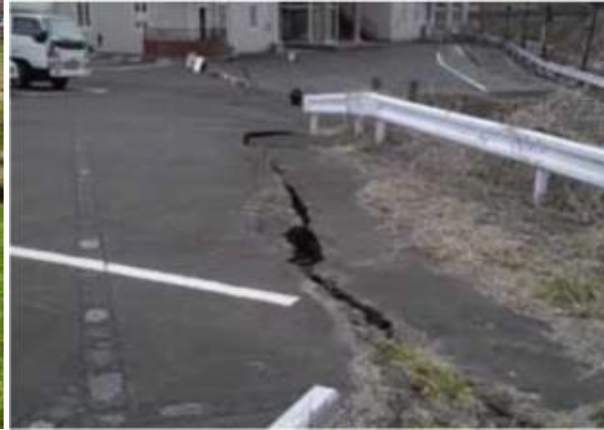
(b)のり肩の亀裂の事例
