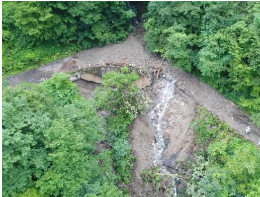
一般県道鶴岡村上線（岩崩地内）の被災（令和元年7月）
