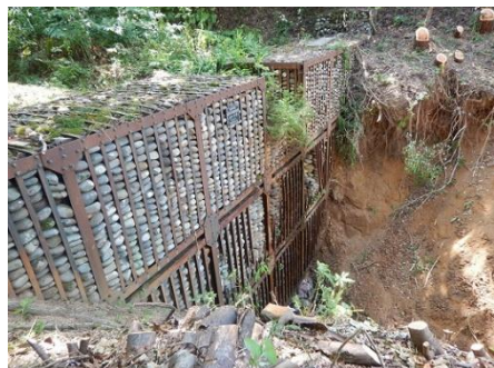
〈施工前 鋼製谷止工の腐食 と袖部の浸食〉
