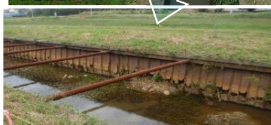
〈軽量鋼矢板護岸の腐植状況〉
