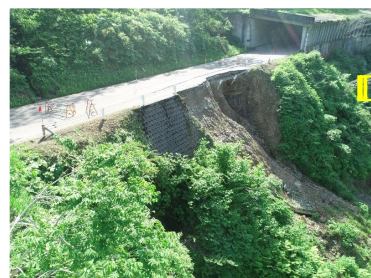
主要地方道上越安塚柏崎線 道路崩落状況(R7.5撮影)
