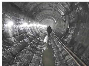
円上寺隧道が建設された当時は、トンネルの覆工材料としてはレンガや石材が主流でした。日本に現存するコンクリート製トンネルでは最古と言われています。
