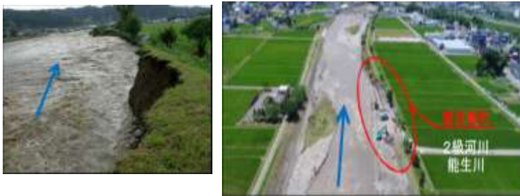
図 堤防欠損の発生例
