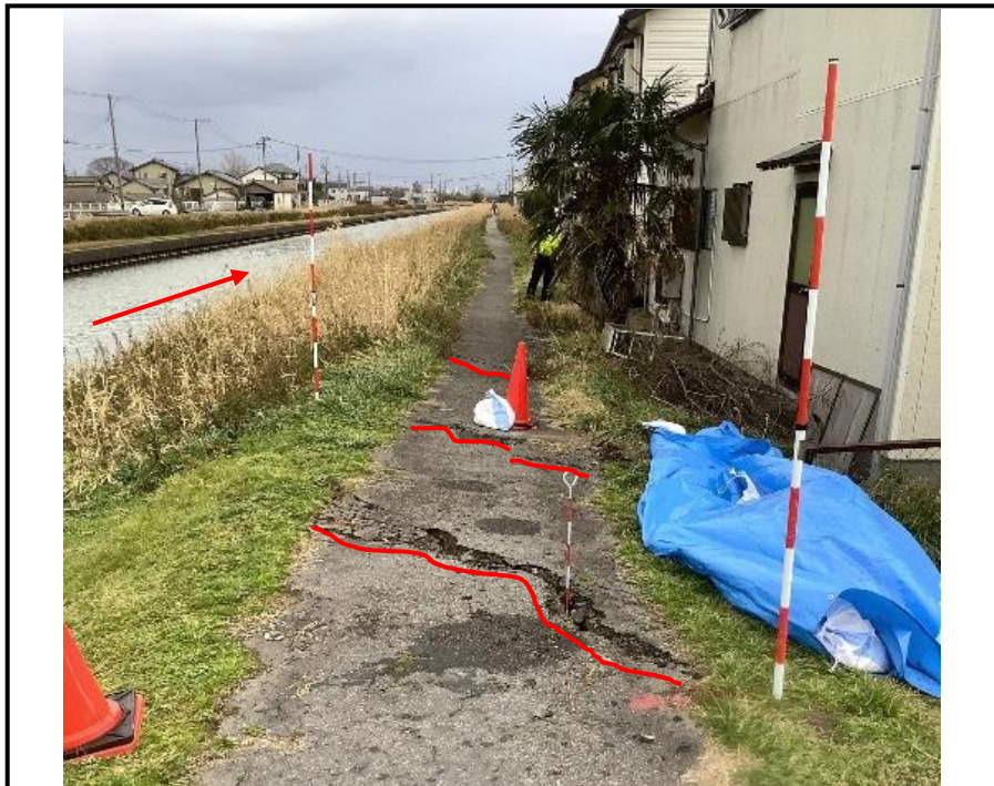
令和6年1月頃の亀裂の様子（中間地点付近）
