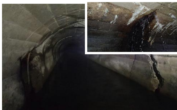
< コンクリートの劣化により漏水が進む水路トンネル >
