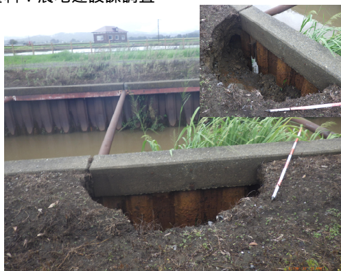
< 腐食により背面が陥没した鋼矢板水路 >
