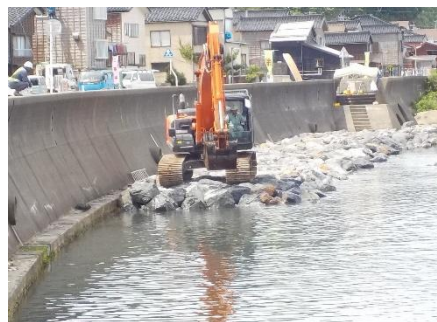
<耐震対策を施している海岸保全施設（出雲崎）>
