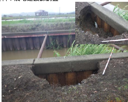
< 腐食により背面が陥没した鋼矢板水路 >
