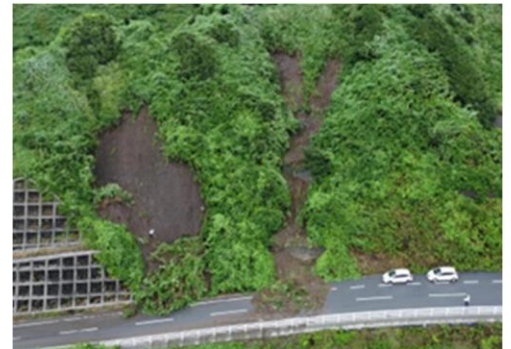
< 令和 7 年 8 月豪雨による被害状況 (佐渡市沢崎) >
