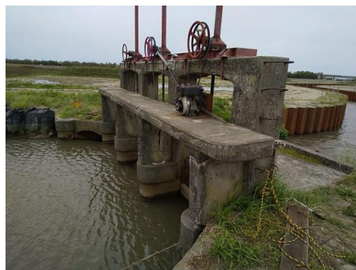
< 老朽化して開閉が困難になったゲート >
