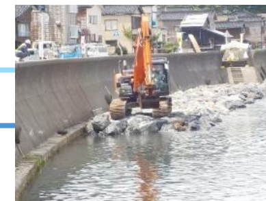
<耐震対策済の海岸保全施設>
