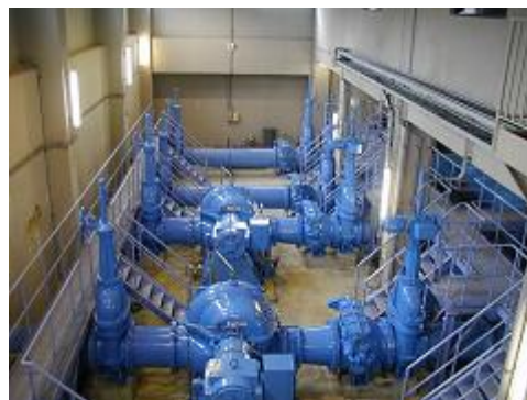
沢口導水ポンプ場
