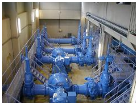
沢口導水ポンプ場
