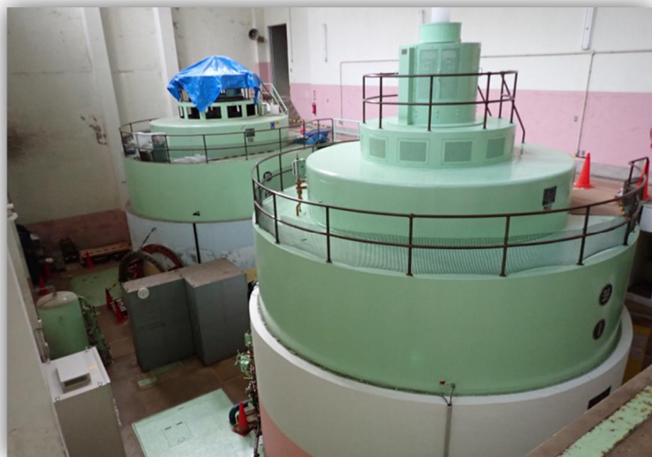
電気事業 (猿田発電所)
