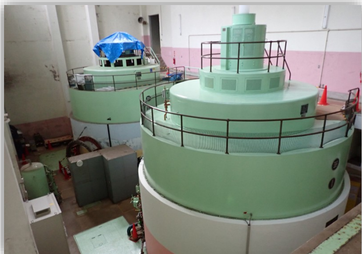
電気事業 (猿田発電所)
