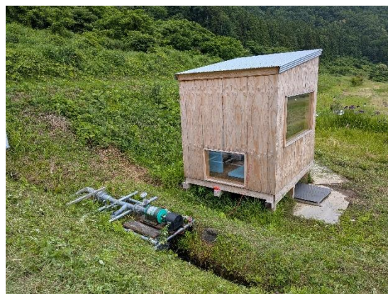
小水力発電施設
