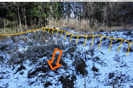
大所工区下部ブロック頭部の段差
