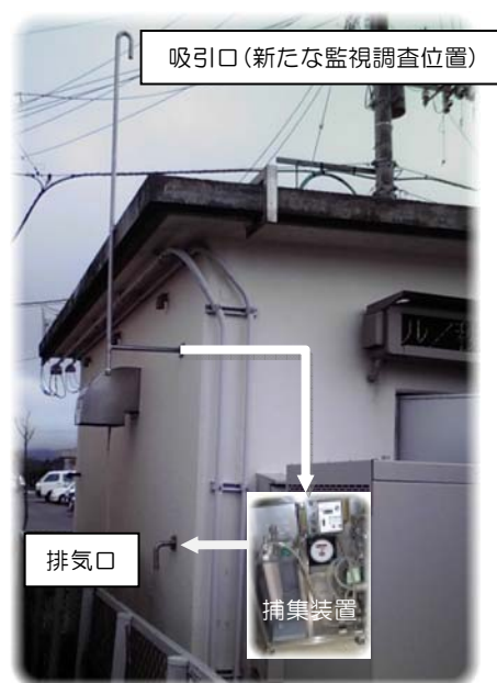
Fig. 5 刈羽局に設置した吸排気管
