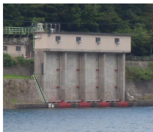
■取水口 (新潟臨海工業用水道)
