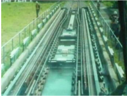
軌間変換装置(地上側)
