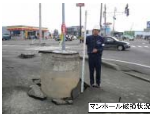
管渠破損状況
