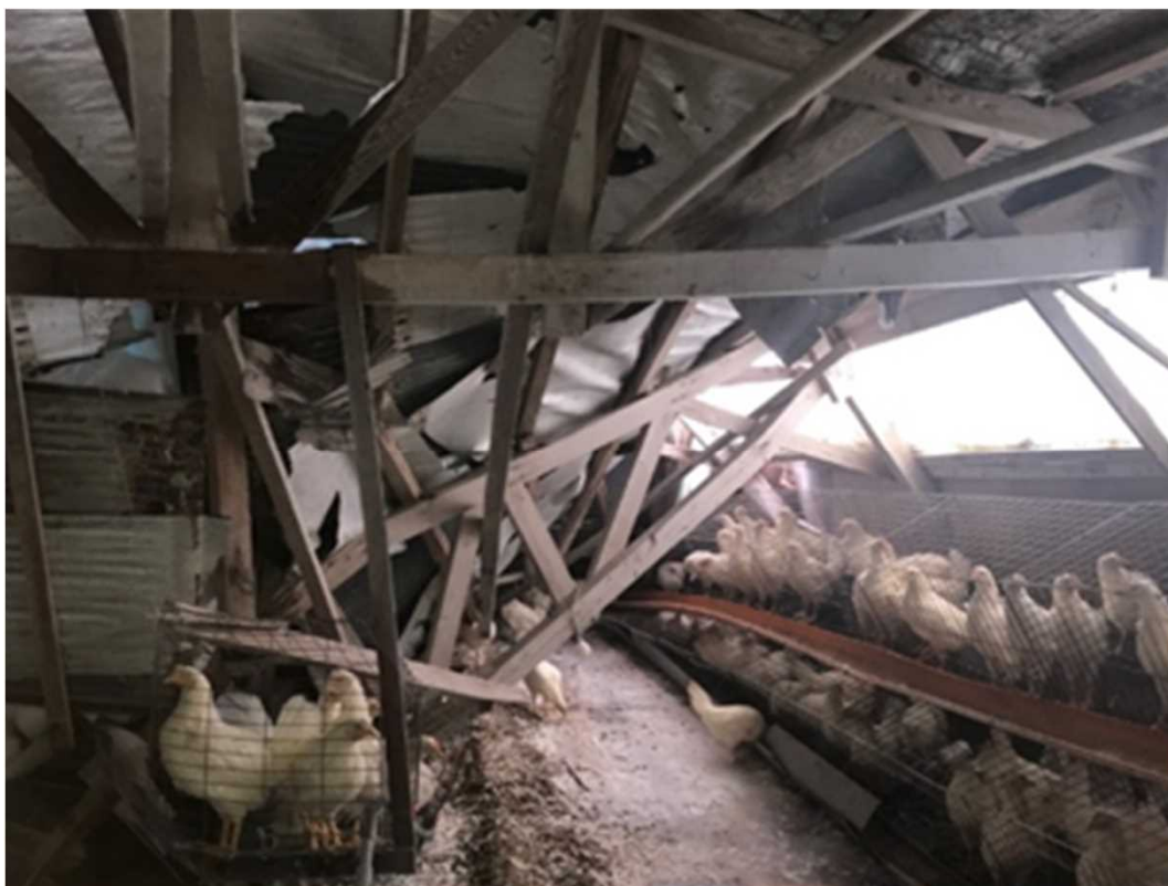
雪による鶏舎の倒壊（1/11糸魚川市）
