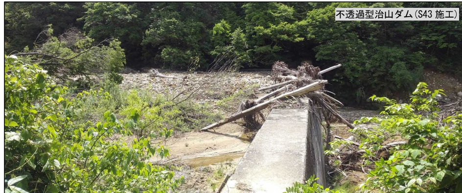
写真 2.5.1. 不透過型治山ダムによる流木及び土砂捕捉状況_MR-39（赤坂川）
