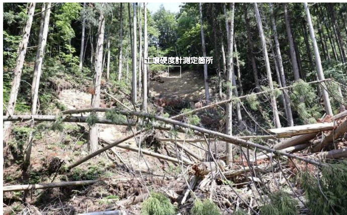
写真② 崩壊地の状況
