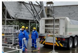
水素トレーラーから水素を供給
