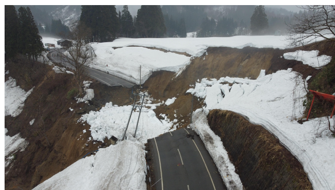
写真① 道路崩落状況（令和7年3月28日撮影）
