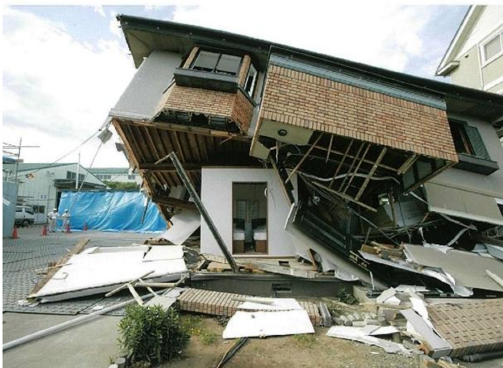
〔耐震シェルターの例〕
